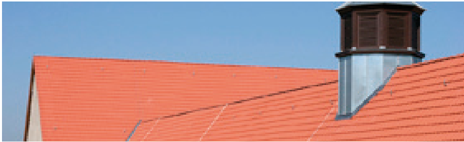
Neues Dach in klassischer Optik: „Finkenberger Pfannen“ mit KlimaLife-Oberfläche auf einem Schulgebäude aus den 40er Jahren. Foto: Nelskamp
