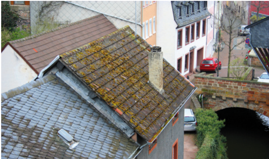
Moosbildung auf nassen Beton- dachsteinen und Moselschiefer
