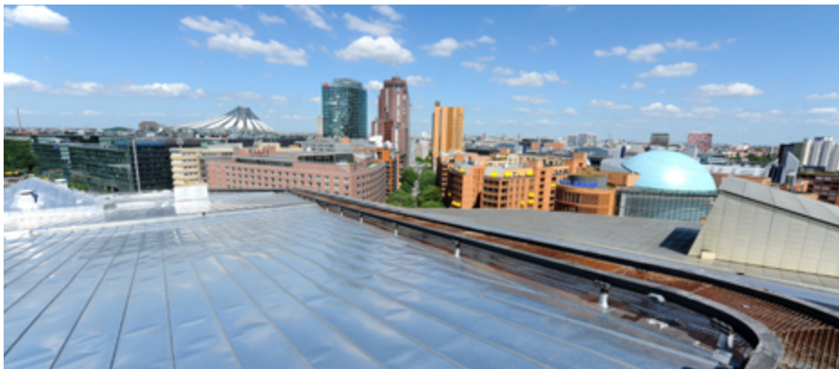
Dach Staatsbibliothek mit Leckageschutz; Foto Progeo
