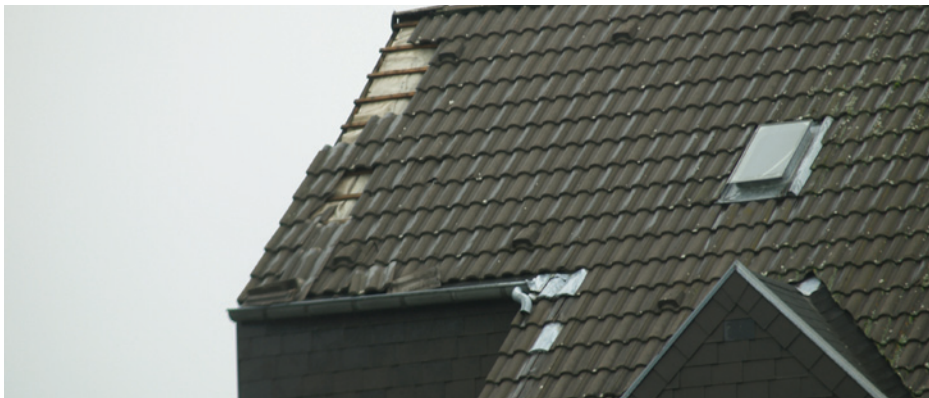
Luftwirbel greifen unter die Dachziegel, Fotos privat
